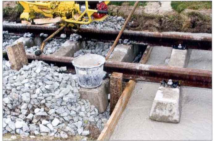
Während der Bauarbeiten gut zu erkennen: links die herkömmliche Bauweise und rechts der in die Schalung gegossene Softbeton als feste Fahrbahn. Aufnahme: Schiffner/Matthäi Gleisbau
